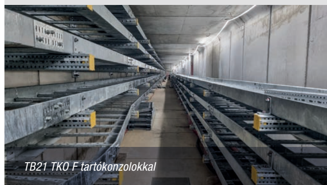
siFramo tartóelemek a Tokamak épületben
